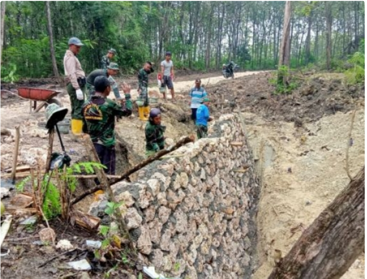
Satgas TMMD Reguler ke-113 Kodim 0721/Blora bersama warga langsung kebut pembangunan talud di Desa Pengkoljagong
